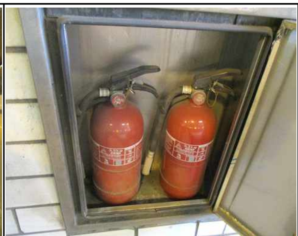
하행선 소화기 전경
