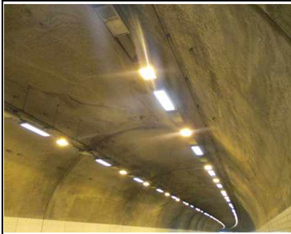
상행선 조명시설 전경
