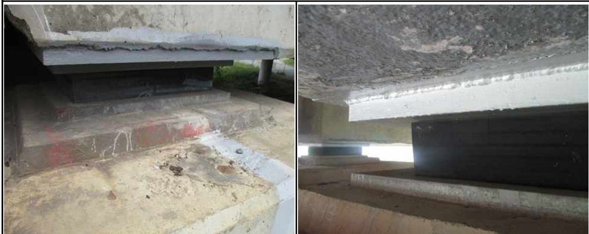
하행선 P3-SH1 무수축물탈 균열
