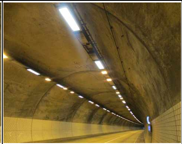
하행선 조명시설 전경
