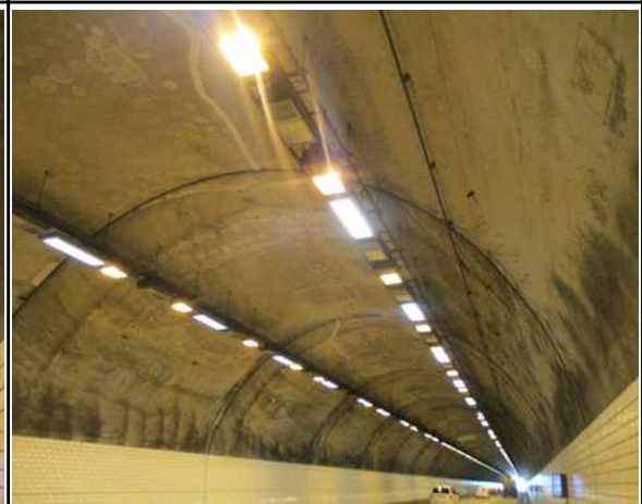
하행선 조명시설 전경
