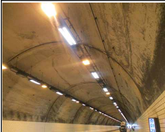
상행선 조명시설 전경
