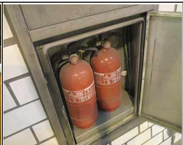
하행선 소화기 전경
