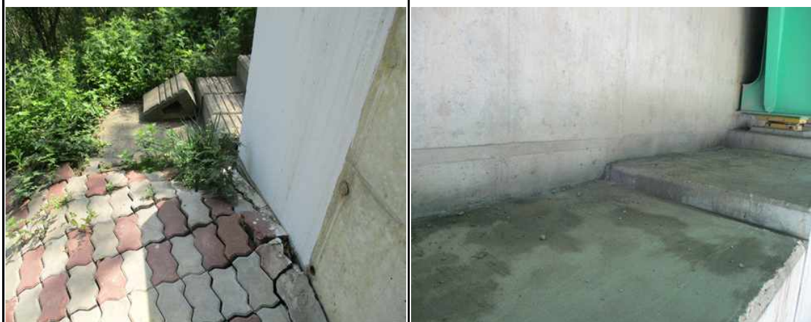
교대 상행선 A1 범면 보호블럭 침하
