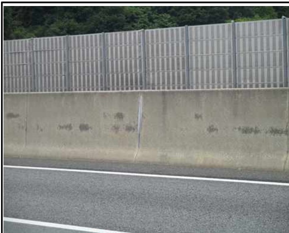
상행선 S3 중앙분리대 균열부 백태
