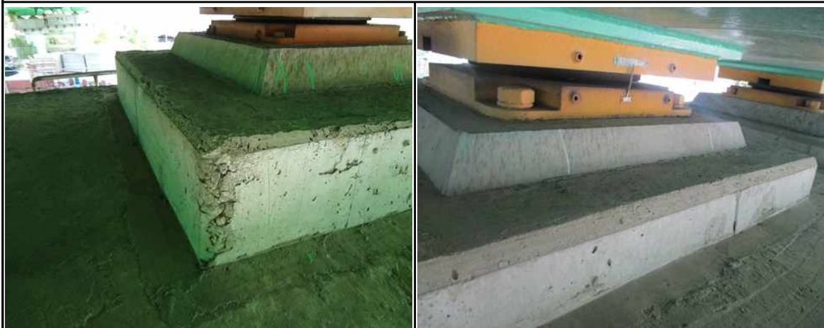
상행선 P1-SH3 받침콘크리트 재료분리
